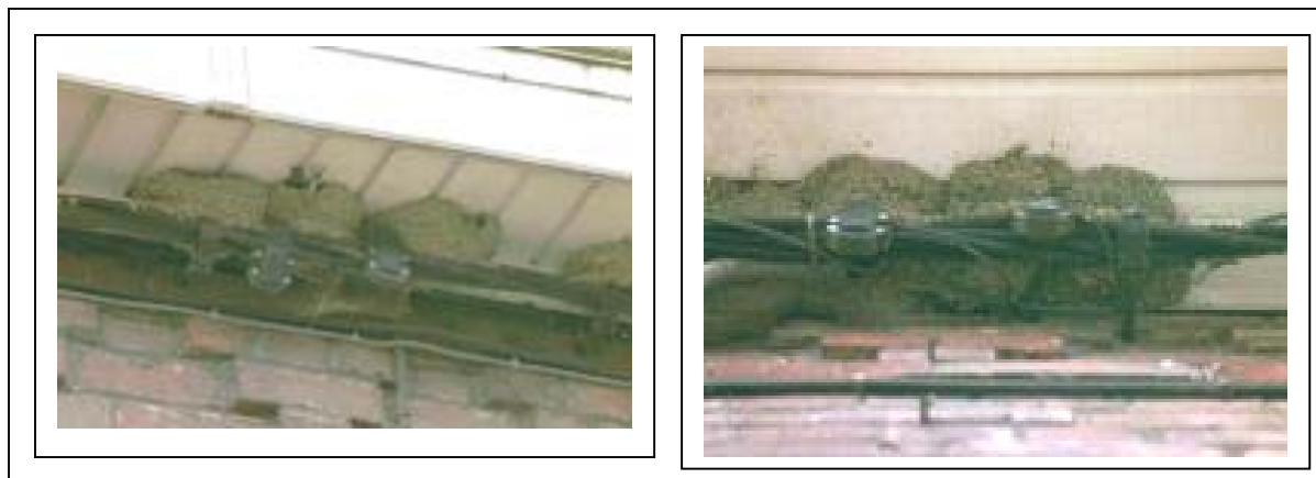
Fig. 15 a en b: Volle nesten op electriciteits-kabel Wevelgem: Menenstraat 365 en 344
